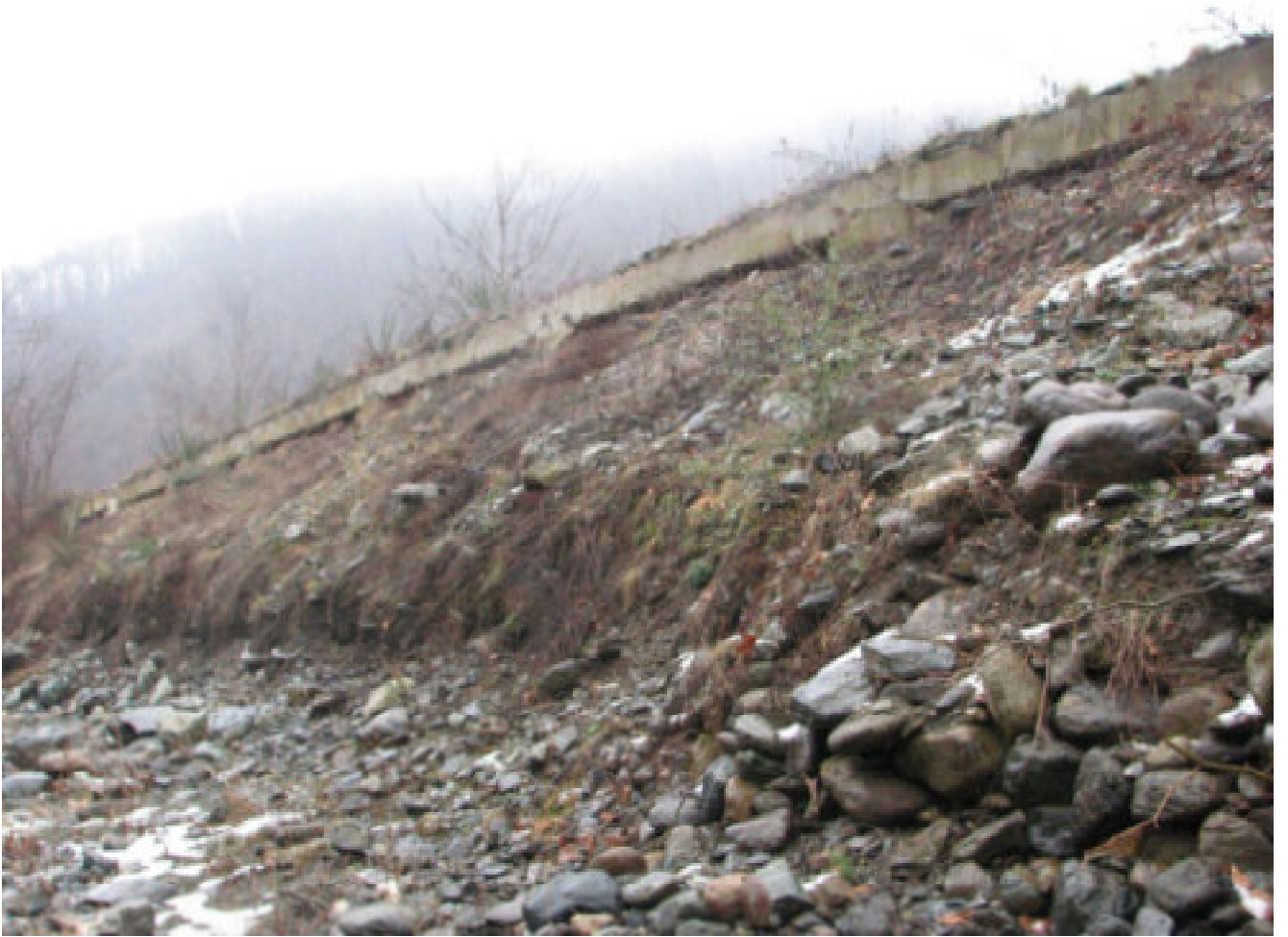
FOTO N.7 - INTERVENTO 2 - PARTICOLARE DELLA FRANA IN SPONDA DESTRA (in sommità la condotta fognaria)
