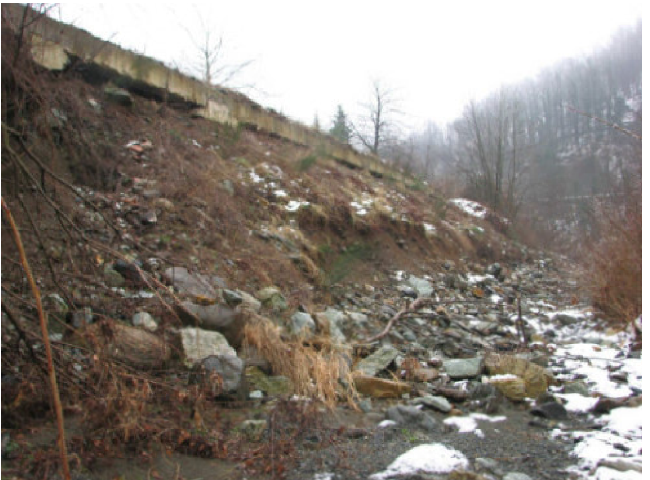
FOTO N.8 - INTERVENTO 2 - VISTA DA VALLE DELLA FRANA IN SPONDA DESTRA (in sommità la condotta fognaria)
