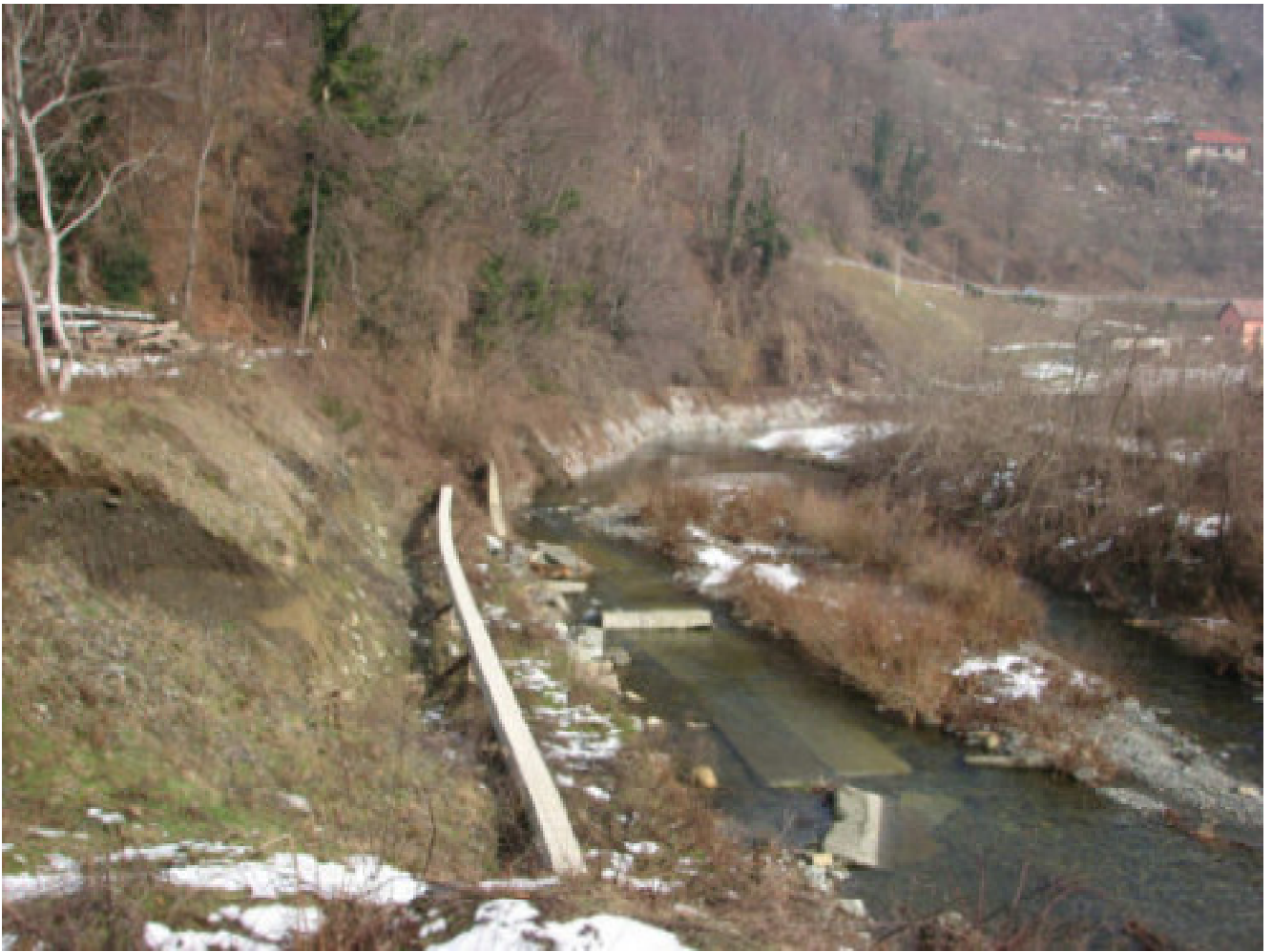
FOTO N. 3 - INTERVENTO 1 – LA FOGNATURA ED IL MURO CROLLATO
