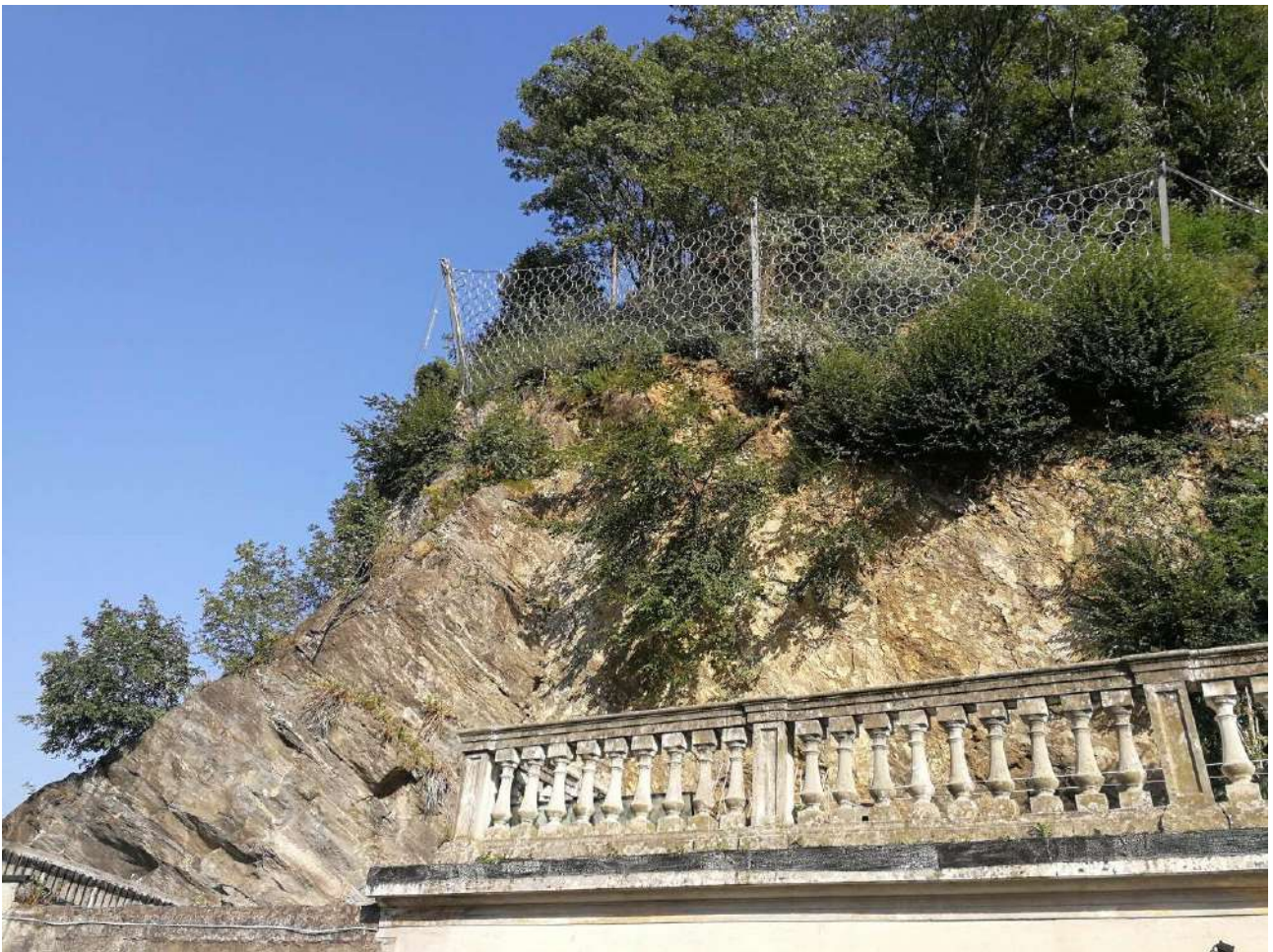
Foto 1: Barriere paramassi posate in Somma Urgenza con sottostante parete in condizioni critiche
