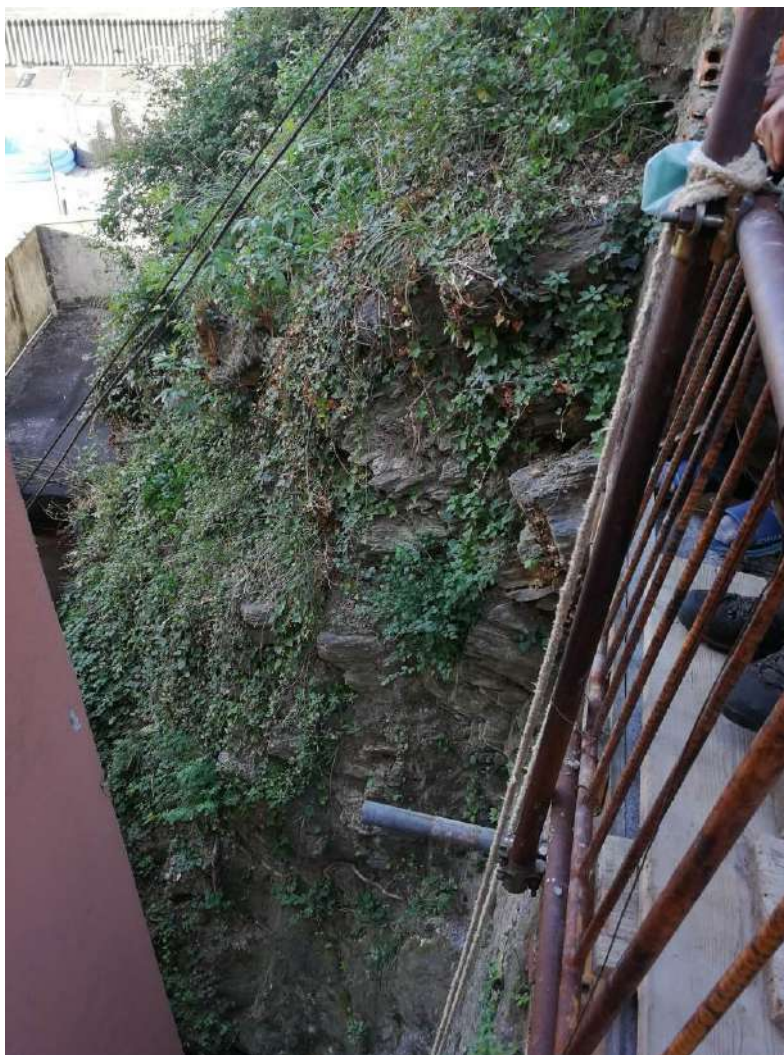
Foto 2: Vista dall'alto della parete in condizioni critiche
